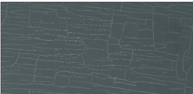
Das Gefüge ist durchgängig durch die UV-Strahlung geschädigt.
