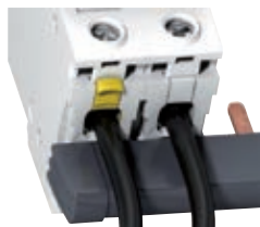
Kammschiene und Kabel
